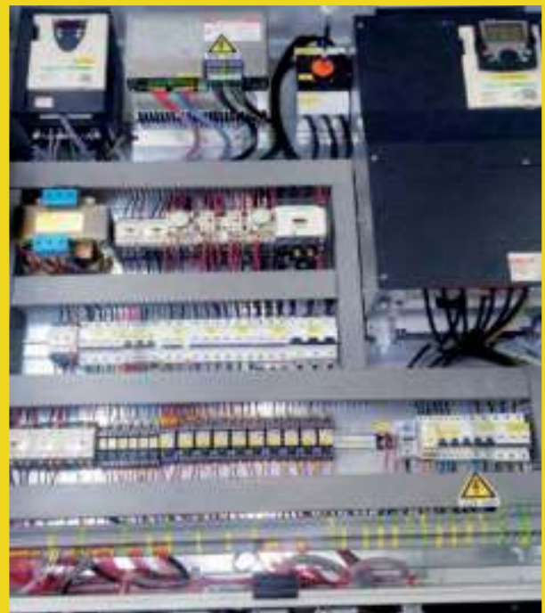
QUADRO ELETTRICO ELECTRIC PANEL
